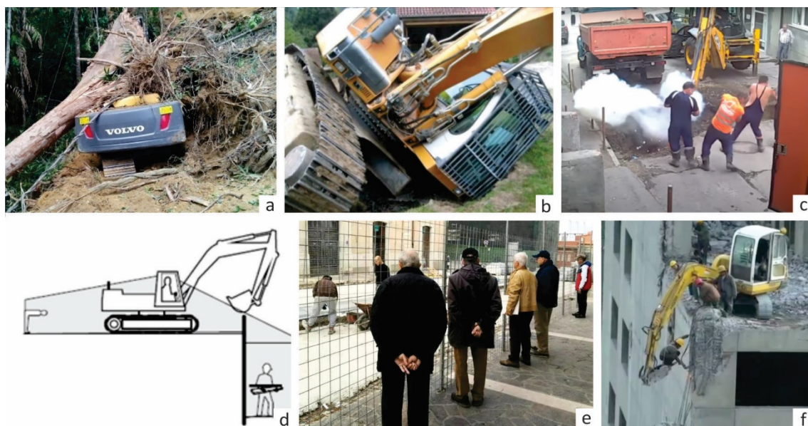
SLIKA 2 - SPECIFIČNE OPASNOSTI PRI ISKOPU I TRANSPORTU ZEMLJE
