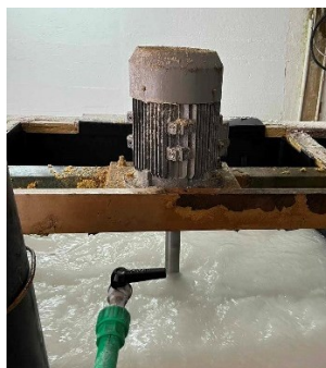
СЛИКА 7 - Дозирање алуминијум – сулфата [2]
