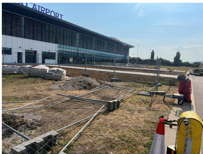
Slika 4. Primer oborene ograde tokom izvođenja građevinskih radova od izduvnog mlaza motora vazduhoplova koji se sopstvenim pogonom isparkiravao na platformi
