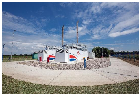
SLIKA 4 – MALA GASNA ELEKTRANA U SRBOBRANU
