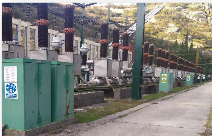
SLIKA 4 – VISOKONAPONSKO POSTROJENJE 110kV
