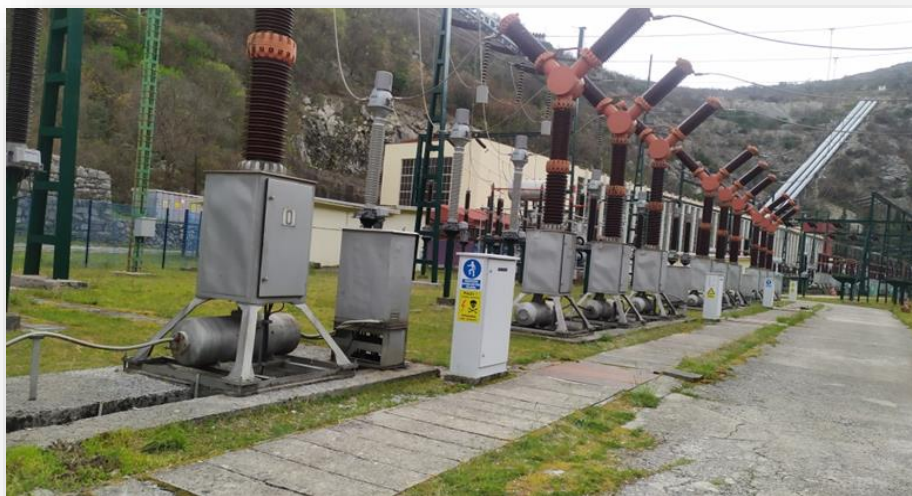
SLIKA 3 – VISOKONAPONSKO POSTROJENJE 220kV
